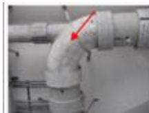
Tuyauteries en fibrociment
