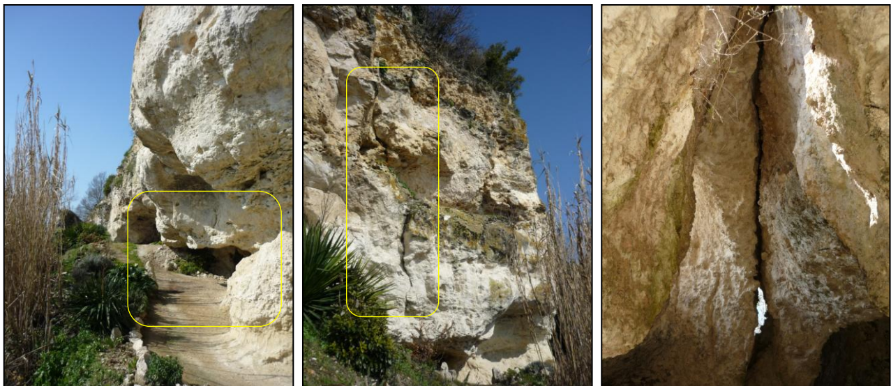
Figure 17 : Sous-cavage en pied d'escarpement et fractures ouvertes dans la roche [Source : IMS RN ]
