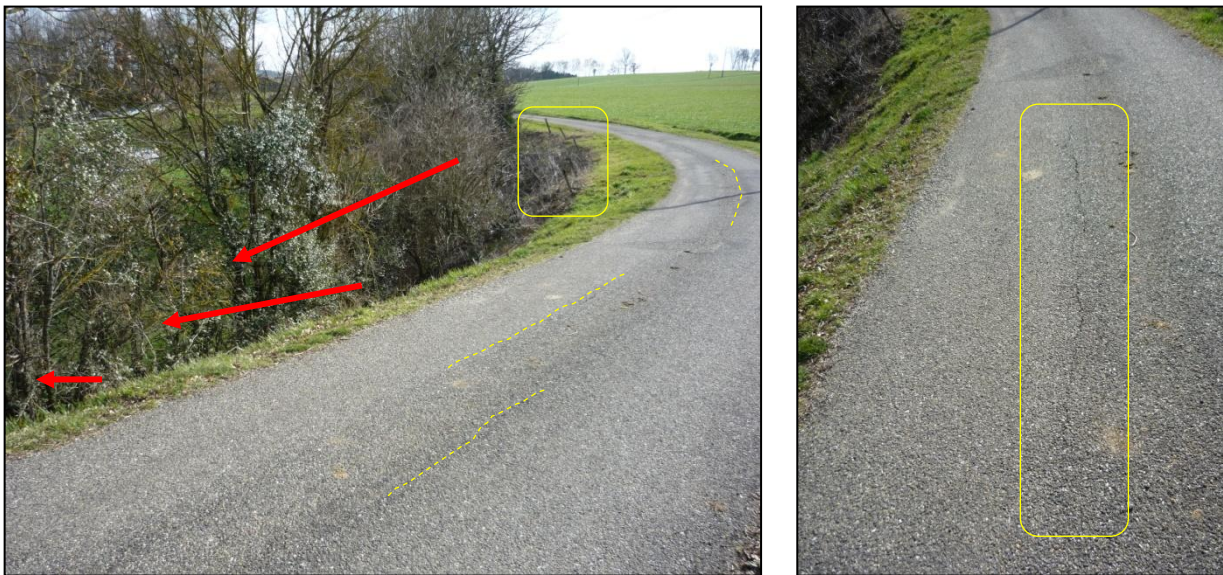
Figure 19 : Légère fissuration et déformation de la chaussée près de Salobert (à noter également les poteaux inclinés dans le talus à l'intérieur du virage) [Source : IMS RN ]
