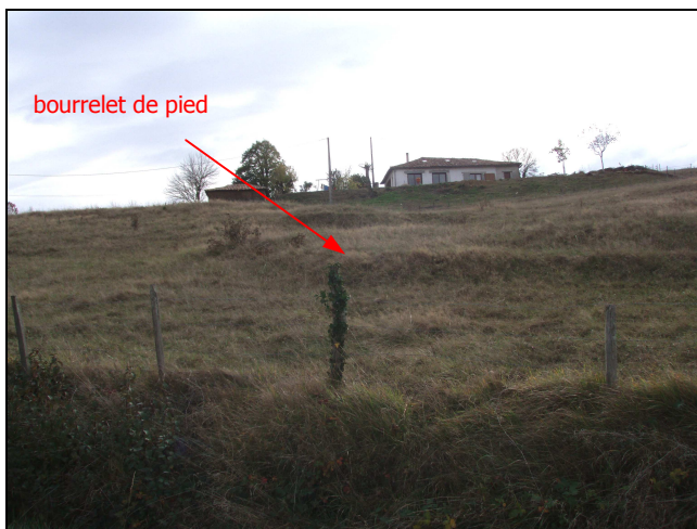
Lieu dit « Grange Neuve » Loupe de glissement
