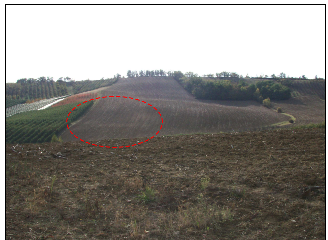
Lieu dit « La Croix des Trépassés » Ancien glissement
