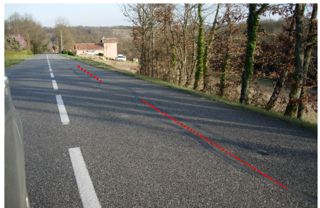
R.D. 2 Affaissement de remblai
